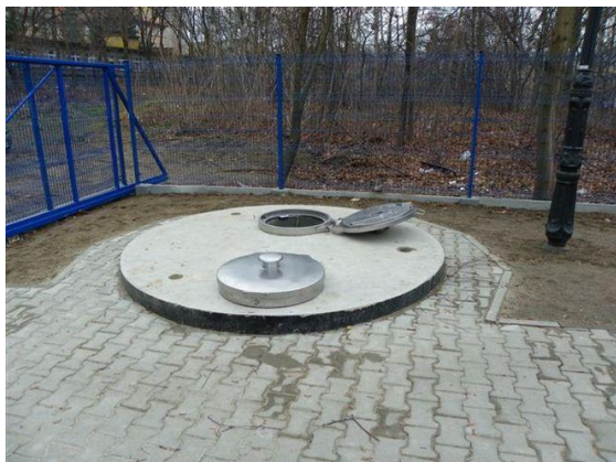
Fig. 1: Water intake on Tęczowa Street.
